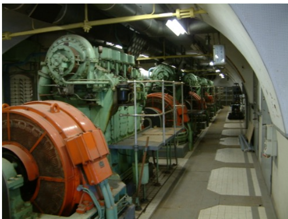
Vijf van de acht diesелgeneratoren in het gebouw van het Fort Westoever. (René Ros)
