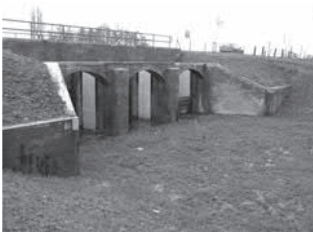
De landzijde van de grootste inlaatsluis in de Stelling, voor het inunderen van de droogmakerij Beemster, kort na de restauratie in 2006.
